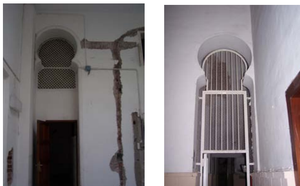
19. Accesos en arco de herradura que comunican el parvis con las naves laterales del edificio.
