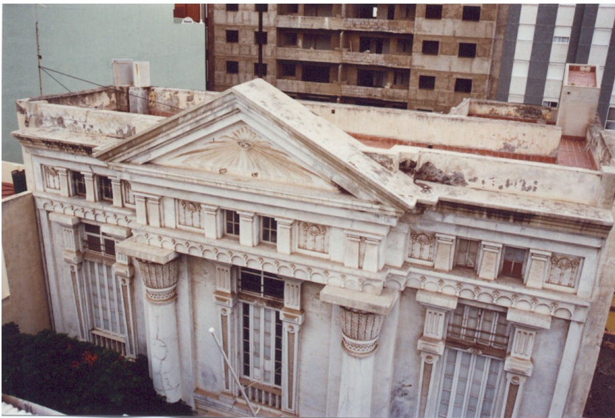
Figura 7: Estado actual de la fachada
