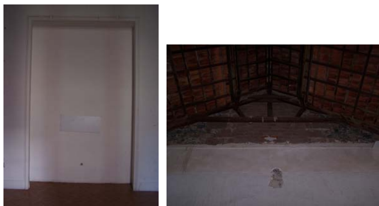
22. Vano en Salón Principal e imagen donde se aprecia que coincide con la armadura de cubierta por el lado del Salón de Tenidas.
